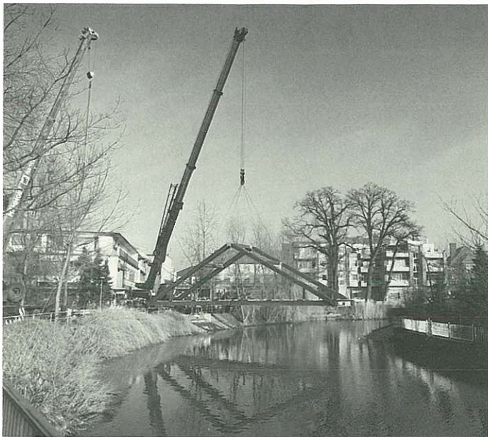
In Nordhorn, Duitsland, plaatste Mammoet Van Wezel uit Ahaus een voetgangersbrug die een gewicht had van 16 ton. De grote kranen gingen met de grootste voorzichtigheid te werk daar de brug geheel van hout is gemaakt en dus zeer kwetsbaar was.
