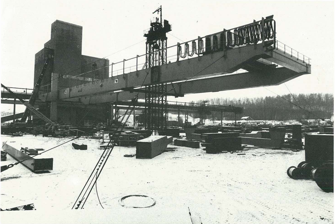
Het hijsen en monteren van een gantry-kraan in Borlänge, Zweden. Heben und montieren eines Laufkranes in Borlänge, Schweden. Hoisting and assembling a gantry crane in Borlänge, Sweden.
